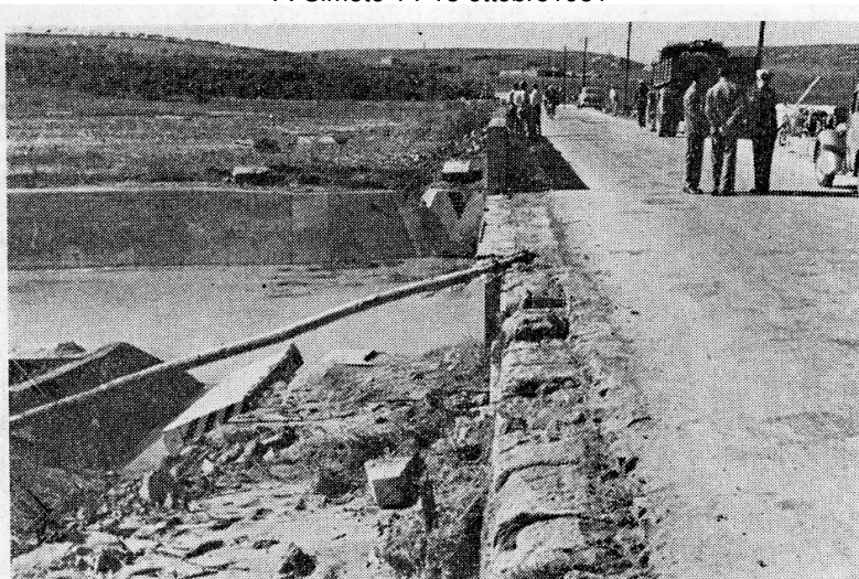
Benante: Asportazione del parapetto a valle del Ponte sul Benante della strada statale n. 114 (foto Marino).
