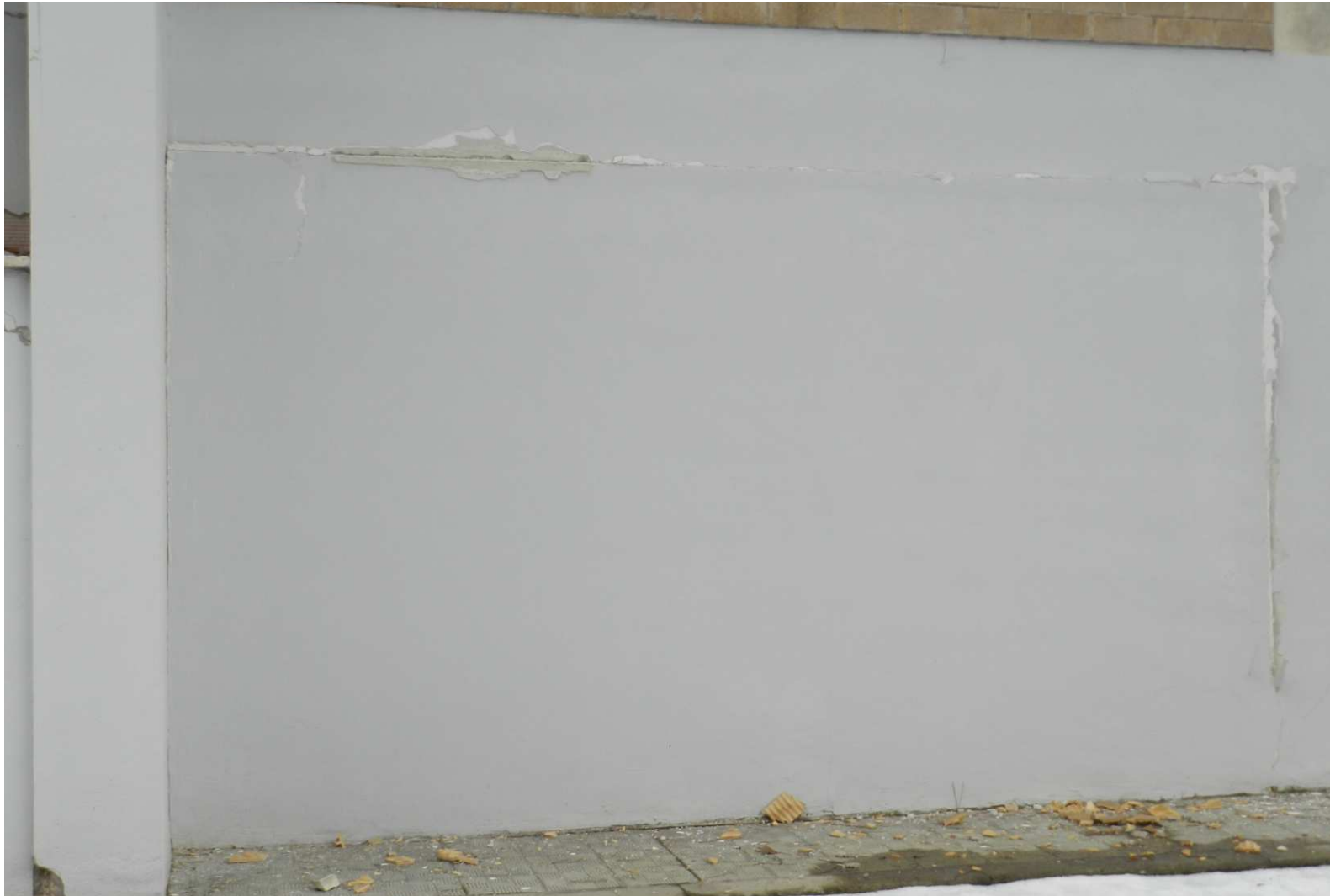
Distacco leggero tra tamponatura e struttura - Norcia, terremoto 30/10/2016
