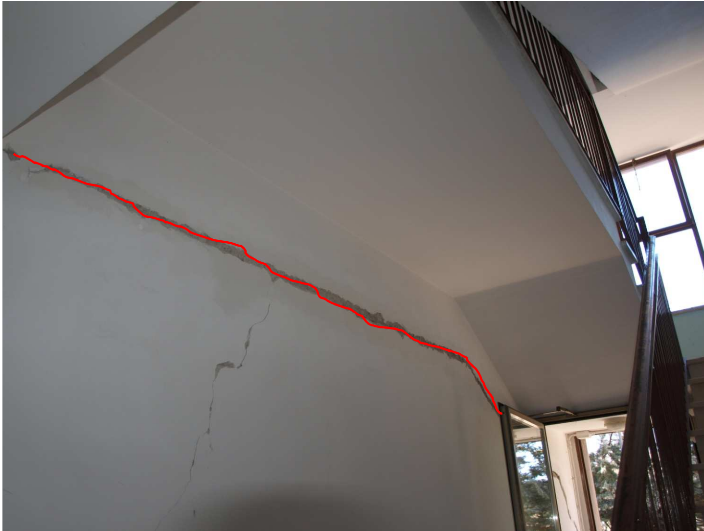
Distacco tra trave a ginocchio e tamponatura - Norcia, terremoto 30/10/2016
