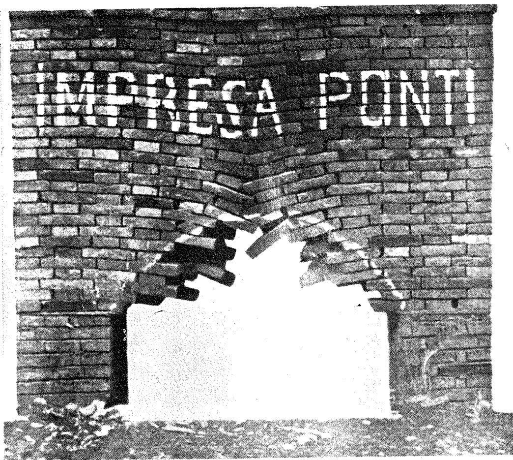
fig. 22 — Un cedimento localizzato in un pannello murario o la presenza di un vano provocano la formazione di un arco di scarico. La presenza di una catena cordolo assicurerebbe lo scarico con lo schema di arco a spinta eliminata. (tratto dal testo di C. Russo: Lesioni dei fabbricati. Utet, vol. I, pag. 60, VIII ed.)
